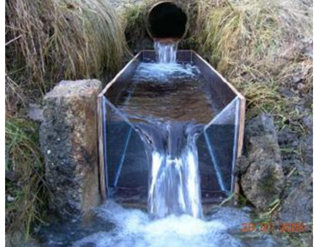
Abb. 4: Dreieck-Messwehr in der Flattach
