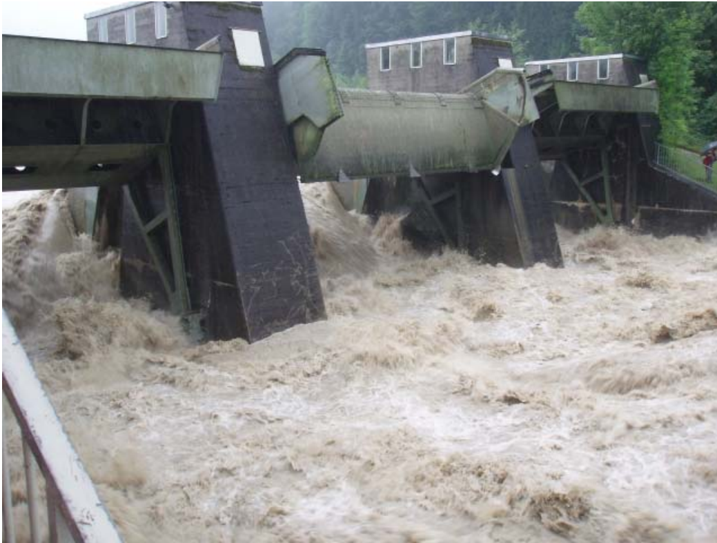
Abbildung 4-13: Große Abflussmengen am Isarkraftwerk Bad Tölz am 24.8.2005. Quelle: WWA Weilheim
