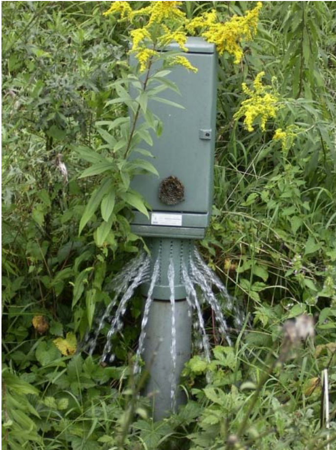
Abbildung 6-4: Schreibgerät-Grundwassermessstelle im Raum Freising, August 2005
