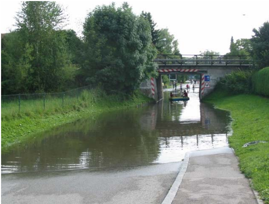
Abbildung 6-3: Überflutung einer Eisenbahnunterführung durch austretendes Grundwasser in Marzling / Freising beim Hochwasser im August 2005. Quelle: WWA Freising
