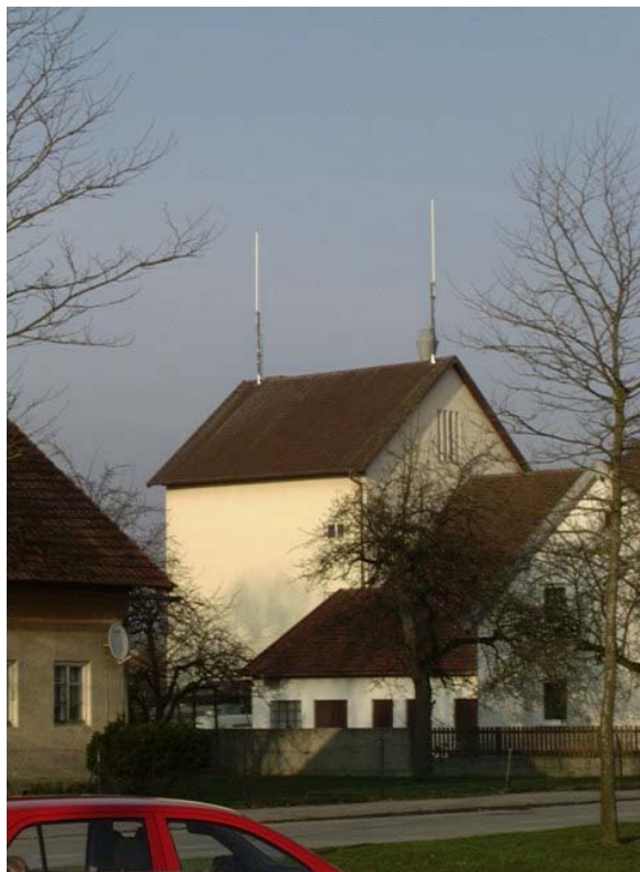
Abb. 4.17: Beispiel für eine Mobilfunkantenne mit Raum-Diversity (hier zwei Rundstrahlantennen, montiert auf einem Gebäudedach).
