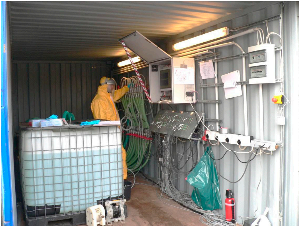
Abbildung 5: Anlagencontainer ISCO Oberfranken
