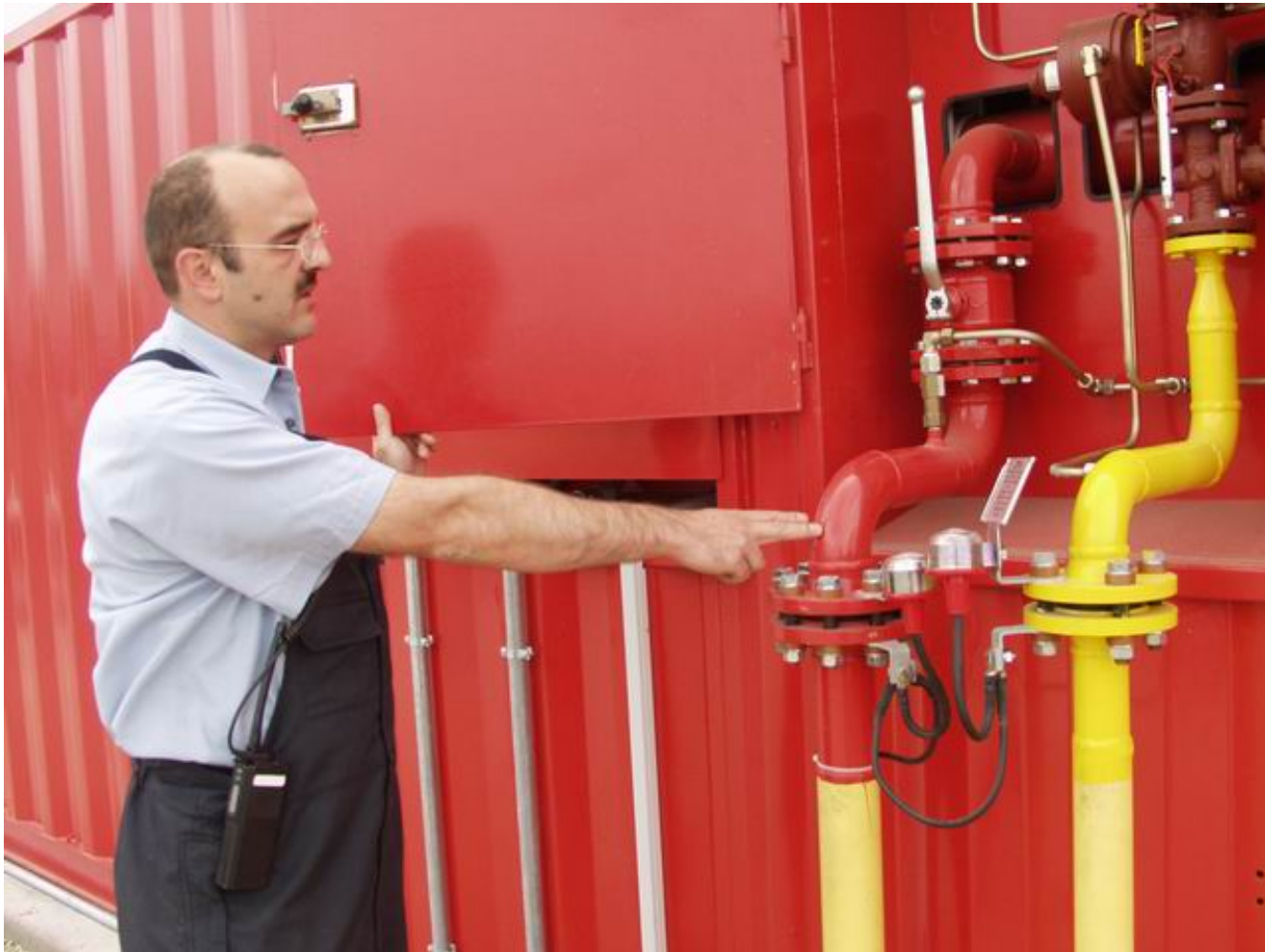
Rohrsystem für Gas und Flüssiggas zur Flächenbrandsimulationsanlage
