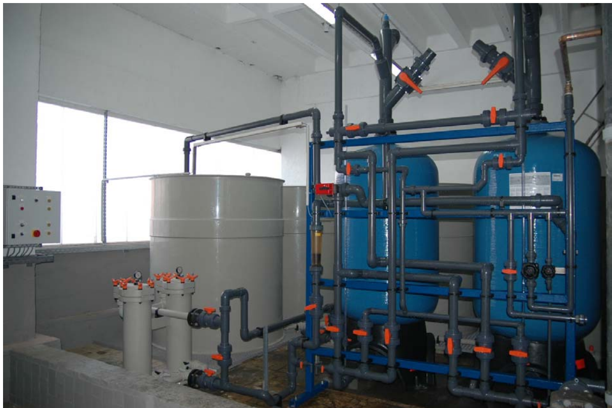
Abb. 3 Schematische Darstellung der Anlagentechnik und Photo der bei Galvanotechnik Breitionen umgesetzten Anlage zur adsorptiven PFT-Abtrennung mittels Aktivkohle
